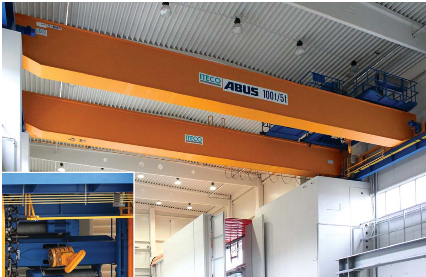
Hala H – laboratoř extrémního zatěžování – jeřáb ITECO-ABUS ZLK 100-5/18,1 D s detailem kočky
