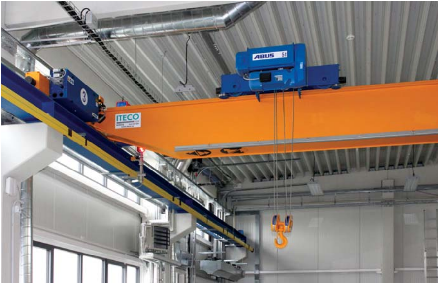
Jeřáb v pavilonu skupiny technologie stavebních hmot a dílců
