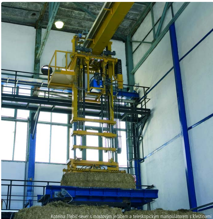
Kotelna Třebíč-sever s mostovým jeřábem a teleskopickým manipulátorem s kleštinami
