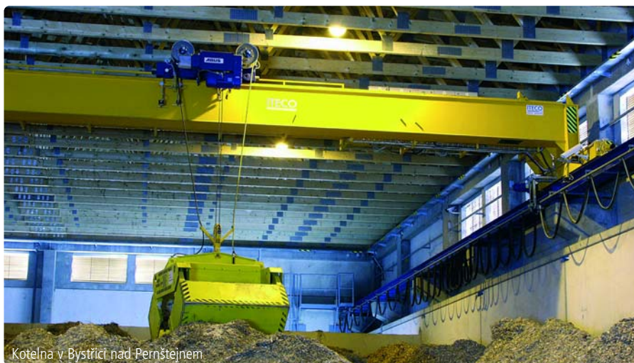
Kotelna v Bystřici nad Pernštejnem
