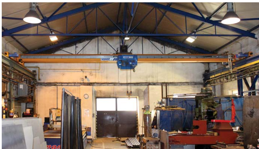
Jednosníkový mostový jeřáb ITECO-ABUS – ELV 3,5/9,8 D v starší hale přípravy materiálu
